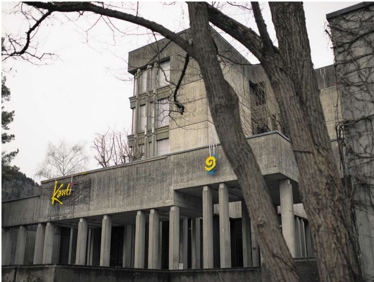
Kalter Beton erhitzt Gemüter: Die Kanti Wattwil sorgt auch in den Sommerferien für Gesprächsstoff. Bild Gian Ehrenzeller
